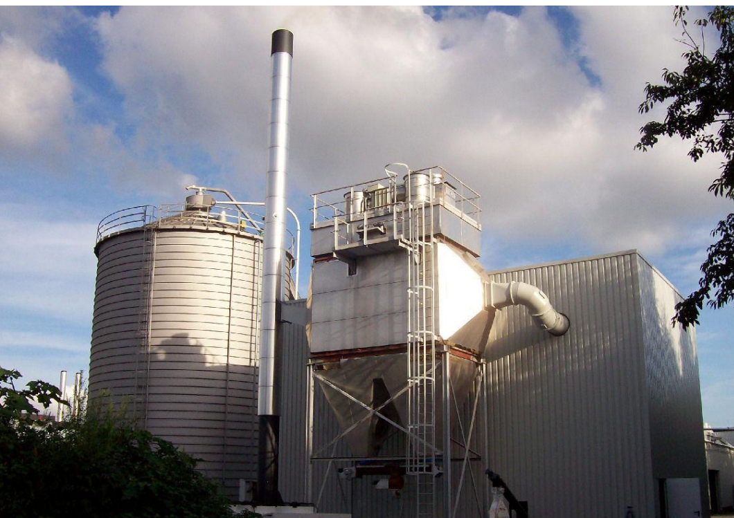
Сухий електрофільтр (KARA)
